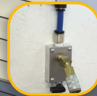
Surface Mount Montaje en Superficie Air line is mounted to wall La línea de aire está montada en la pared
